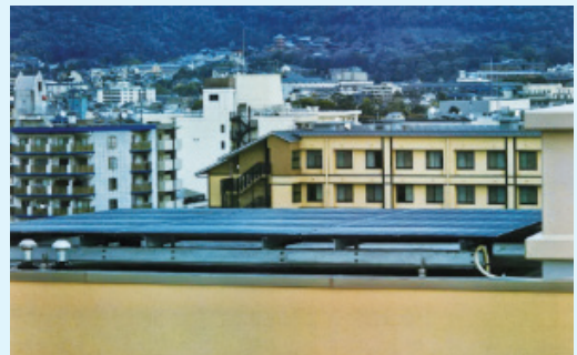
設置した太陽光パネル
