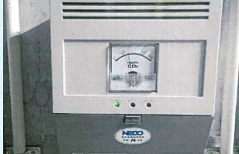
環気ダクトのCO 2 計測器
